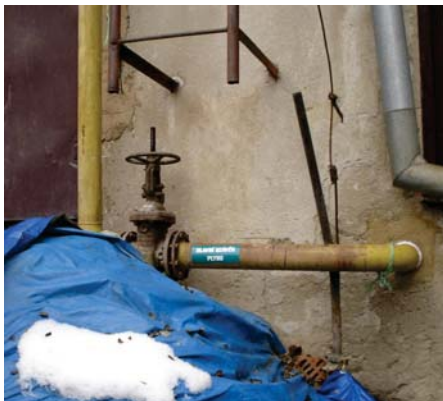
Ukázka závadného stavu v oblasti BOZP, s jakým se inspektoři setkávají v praxi u kontrolovaných subjektů.
